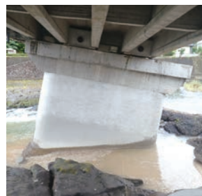
三郎丸橋被災状況
